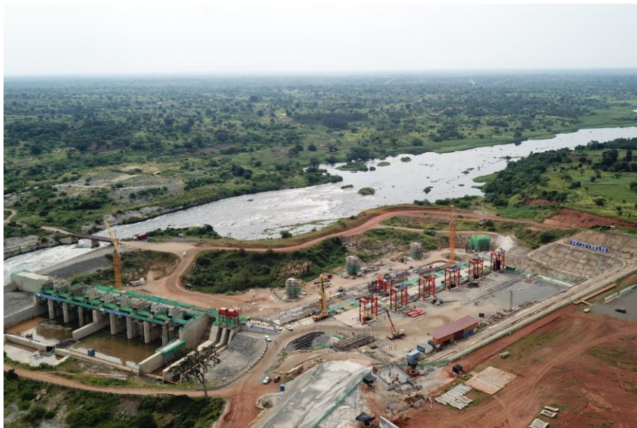
卡鲁玛水电站
